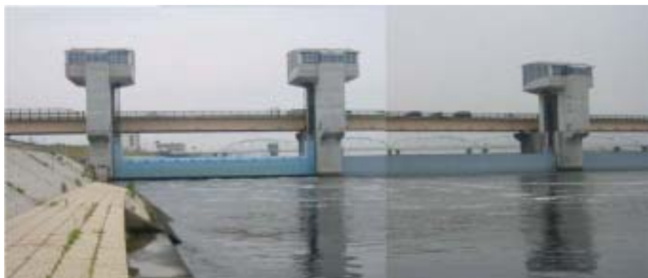
写真 3.22 7号ゲート下段扉放流状況
