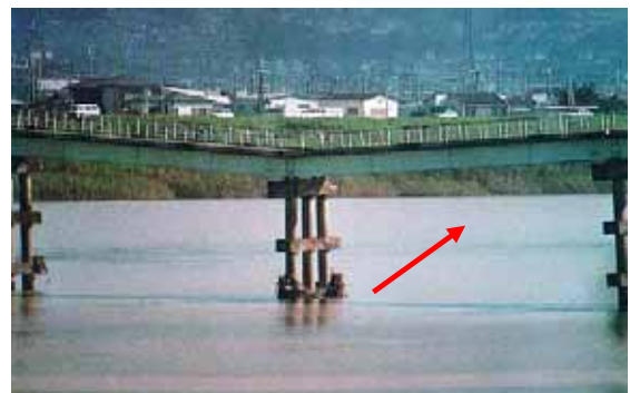
写真 1. 2. 6 川底がえぐり取られて陥没した南海橋 (平成 2 年台風 19 号)
