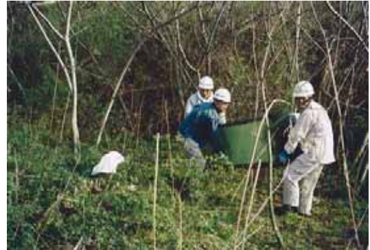
写真 2.4.5 不法投棄の処理状況
