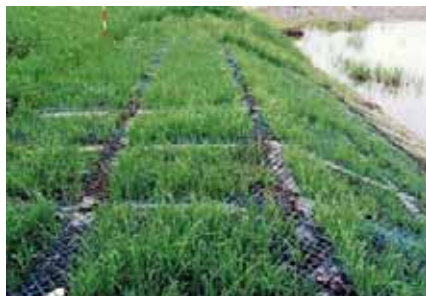
多孔質な水際空間の創出や水際空間の緑化等による生態系に配慮した護岸補修
