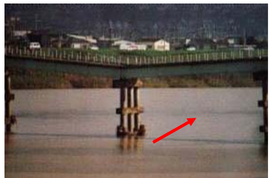
写真 1. 2. 6 川底がえぐり取られて陥没した南海橋 (平成 2 年台風 19 号)
