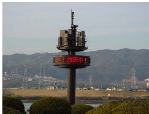
▲紀の川大堰警報局及び電光表示板
