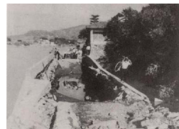
図1.8 昭和28年台風13号による被害状況 (県道海南九度山線・麻生津～竜門間)
