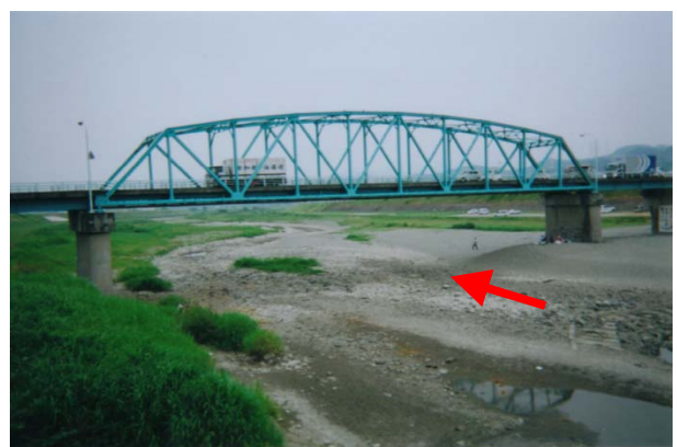
図2.2.5 貴志川の瀬切れの様子(諸井井堰下流(平成14年6月))
