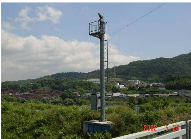
図4.4.9 監視カメラの設置状況(右岸岩出橋付近)
