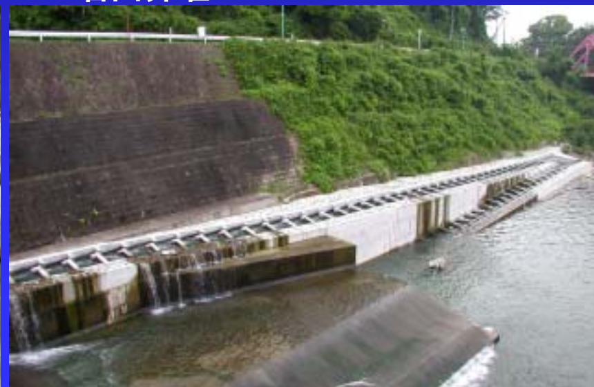
パーチカルスロット式魚道
