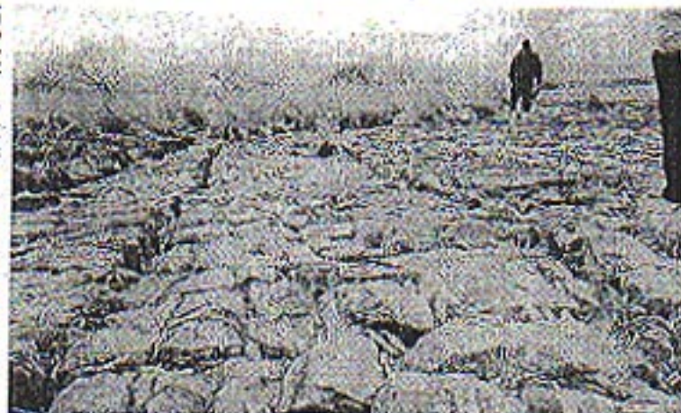
石と木材の組み合わせで築造、250年たつ吉野川の第十堰上堰(吉野川シンポジウム提供)
