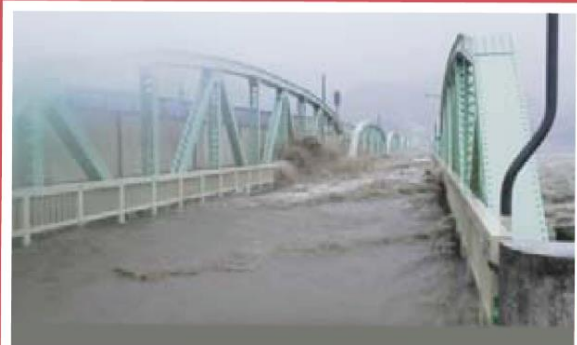
熊野大橋をのみこむ熊野川の濁流 (H23 紀伊半島大水害)
