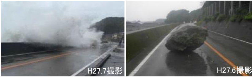
①台風による越波状況 (すさみ町江住地先) ②法面からの落石状況 (串本町田子地先)
