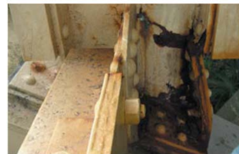
支柱の座屈(国道1号白川橋)
