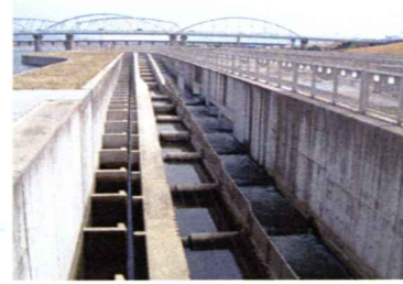
デニール付バーチカルスロット式魚道
