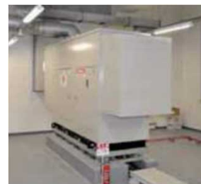
非常用発電設備のイメージ
