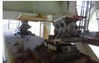
橋梁の支承・主桁の損傷 （大分自動車道・並柳橋）
