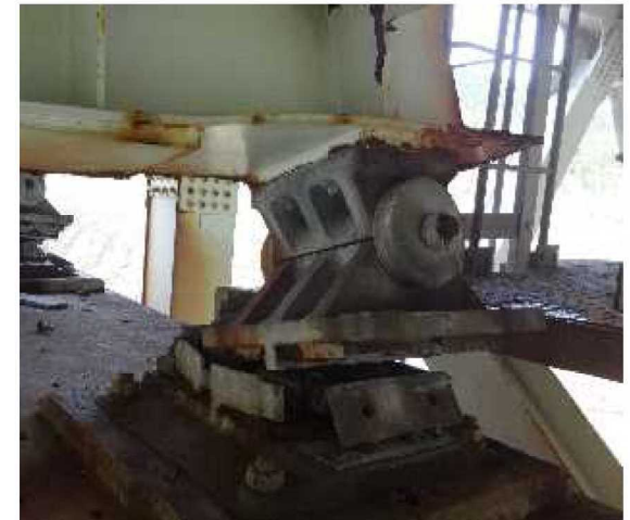
橋梁の支承・主桁の損傷 (大分自動車道・並柳橋)
