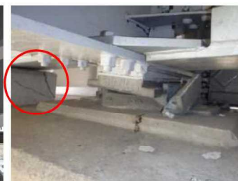
写真-6 支承の破損の状況
