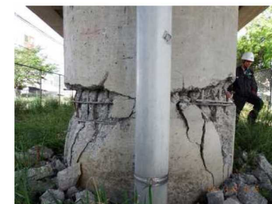
写真-7 段落し部の損傷 ちゅうおうせんりっきょう 市道(1-3)中央線・中央線陸橋
