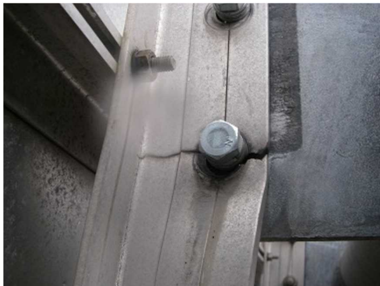
き裂損傷 (車両衝突)
