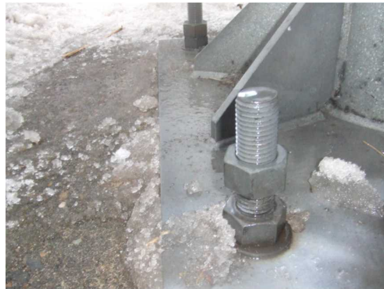
ボルトの緩み (施工不良)
