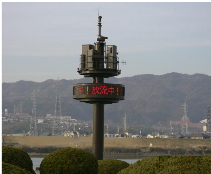
▲ 紀の川大堰警報局及び電光掲示板
