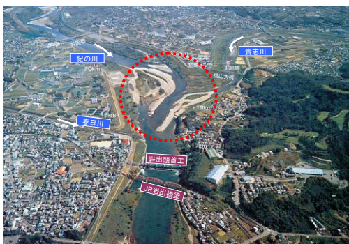
▲ 岩出頭首工上流の土砂堆積状況
