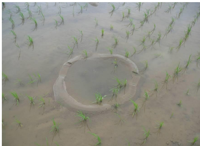
▲ 貴志川漏水被害(H24.6)
