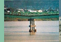
① H2.9.20 (台風19号) 和歌山市栗 南海橋陥没
