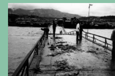
⑲ S28.7.18 (前線) 橋本市 橋本橋橋桁被災状況 「写真:橋本市提供」
