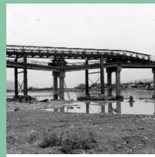
⑯ S34.9.26 (伊勢湾台風) 橋本市 橋本橋橋桁被災状況
