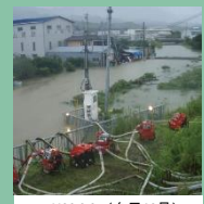
⑬ H23.9.3 (台風12号) かつらぎ町大藪 桜谷川ポンプ排水状況
