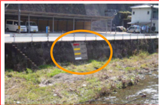
推出大橋付近【不動谷川】 ①水位表示 (H25 町設置) ②カメラ (H26 町設置)
