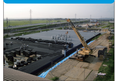
貯留浸透型 (プラスチック製地下貯留槽)
