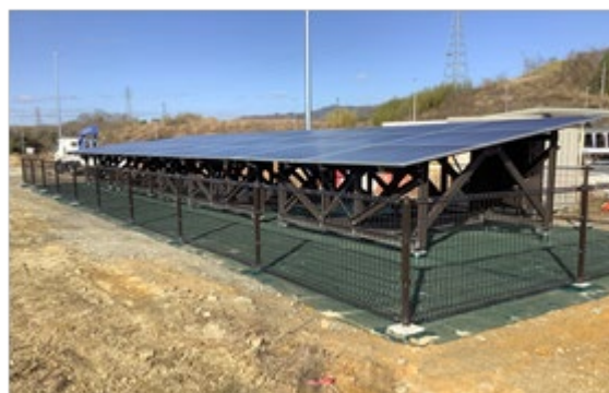
太陽光発電装置外観
