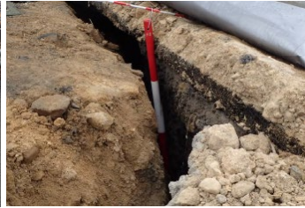
法肩部クラック
