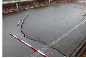
市道路面クラック
