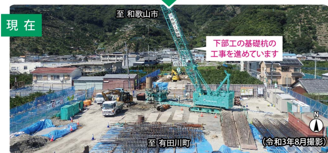
※有田海南道路の橋梁・トンネル名は仮称です。(令和3年9月時点)
