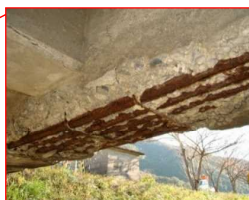
主桁の剥離、鉄筋露出
