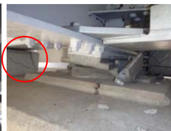
写真-6 支承の破損の状況
