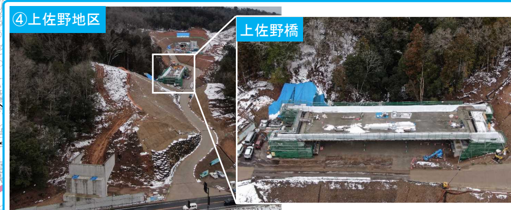
橋梁の橋台や車の落下を防止するための壁高欄のコンクリート打設及び型枠の解体が完了しました。今後は、足場の解体や場内の片付けを進めていきます。
