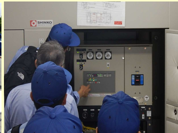
自家用発電機の操作
