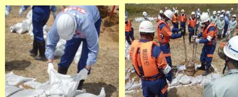
2. 下流側から順に土のう袋を並べ、土を蒔いて上から圧をかけます。
