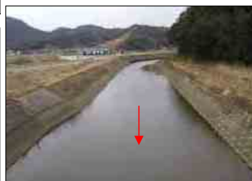
対象地域の護岸の現況
