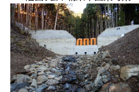
部分透過型治山ダムの設置 (兵庫県 朝来農林振興事務所)
