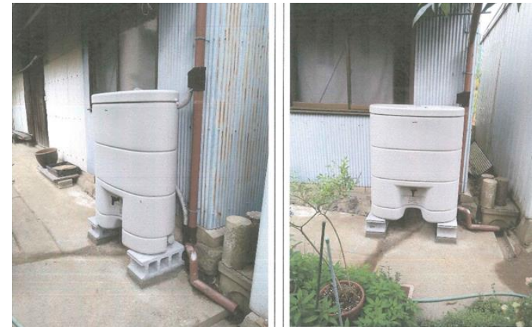
雨水貯留槽設置事例
