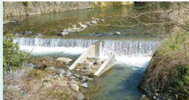
① 過去に設置された魚道が破損
