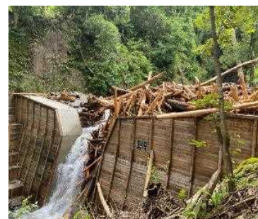
流木捕捉式治山ダムが流木を捕捉した事例【熊本県球磨村】
