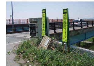
巡視による倒壊看板の確認(H27.5.1)
