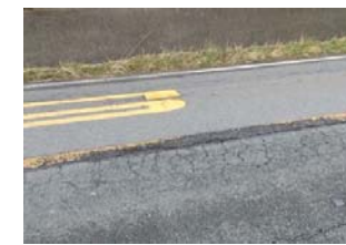
巡視による道路変状の確認(H31.1.25)
