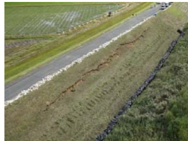
堤防クラック
