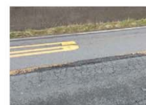
巡視による道路変状の確認(H31.1.25)
