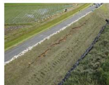
堤防クラック
