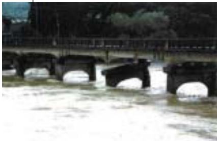
洪水で橋脚が破壊された鶴岡橋
