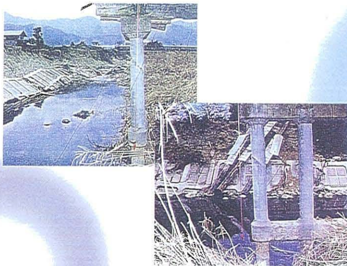
●昭和62年台風19号による与布土川の被害
