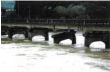
洪水で橋脚が破壊された鶴岡橋
