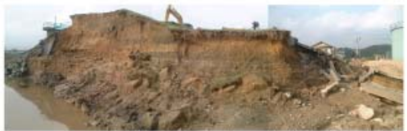
破堤断面(下流側断面)
