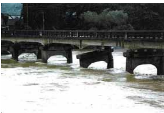
洪水で橋脚が破壊された鶴岡橋
