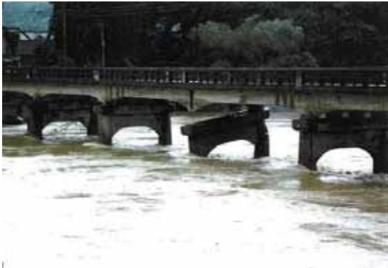
洪水で橋脚が破壊された鶴岡橋
