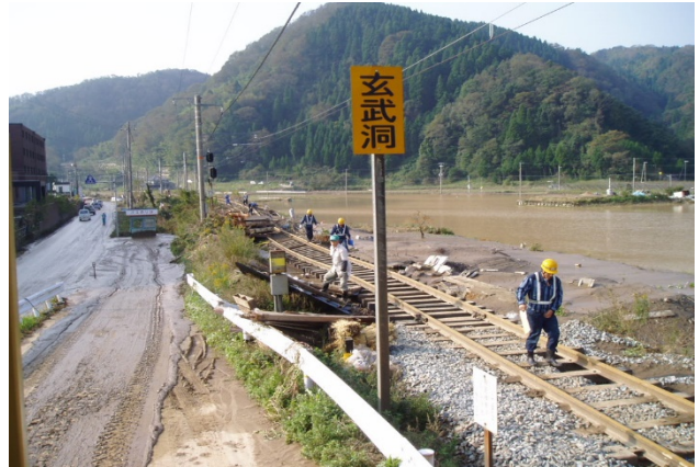
水流により破壊されたJR線路(城崎町上山)
