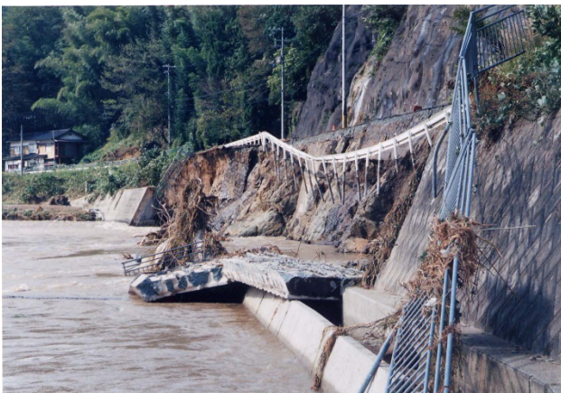
激流により崩落した道路(竹野町森本)
