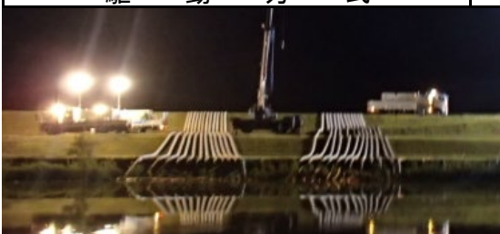
災害時の排水状況
