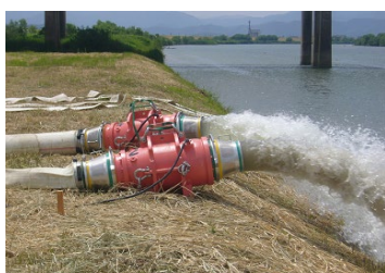
可搬式排水ポンプ
