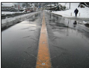
散水融雪設備
