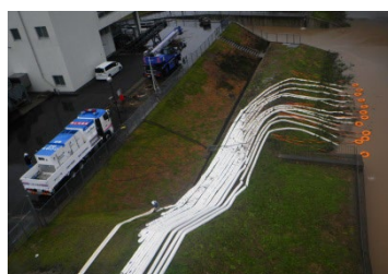
排水ポンプ車 (平成 29 年 10 月 台風 21 号)
