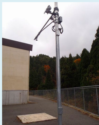
積雪観測設備
