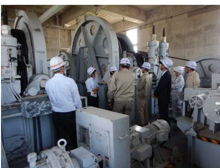
加古川大堰ゲート操作説明
