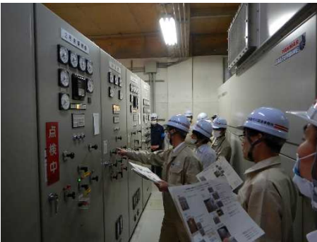
発電装置点検
