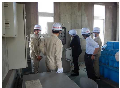
機側操作盤の説明
