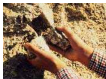
崩れやすい状態
