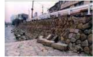
都賀川の川岸の被害
