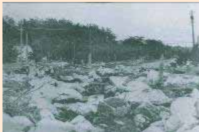
ほうらく 崩落した 住吉川橋
