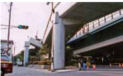
阪神高速道路 の落橋 （川東町付近）
