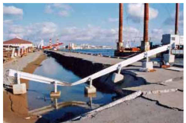
埋立地の液状化現象による被害(西宮浜2丁目)
